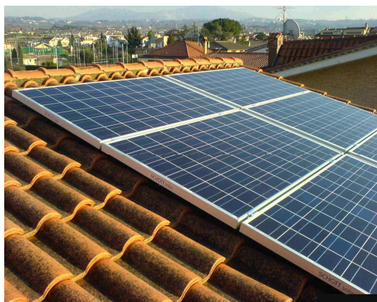
Pannelli fotovoltaici installati sul tetto di un'abitazione
